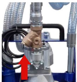
Filtro in aspirazione
